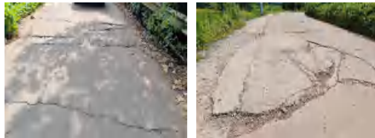
图 3-5 路面破碎板病害
